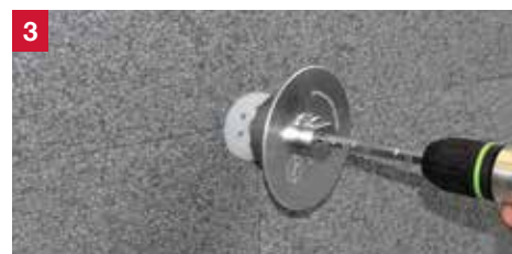
Vissage à l'aide de notre outil ejotherm STR-tool 2GS : le montage à cœur est automatiquement réalisé (pas de fraisage, pas de poussière)
